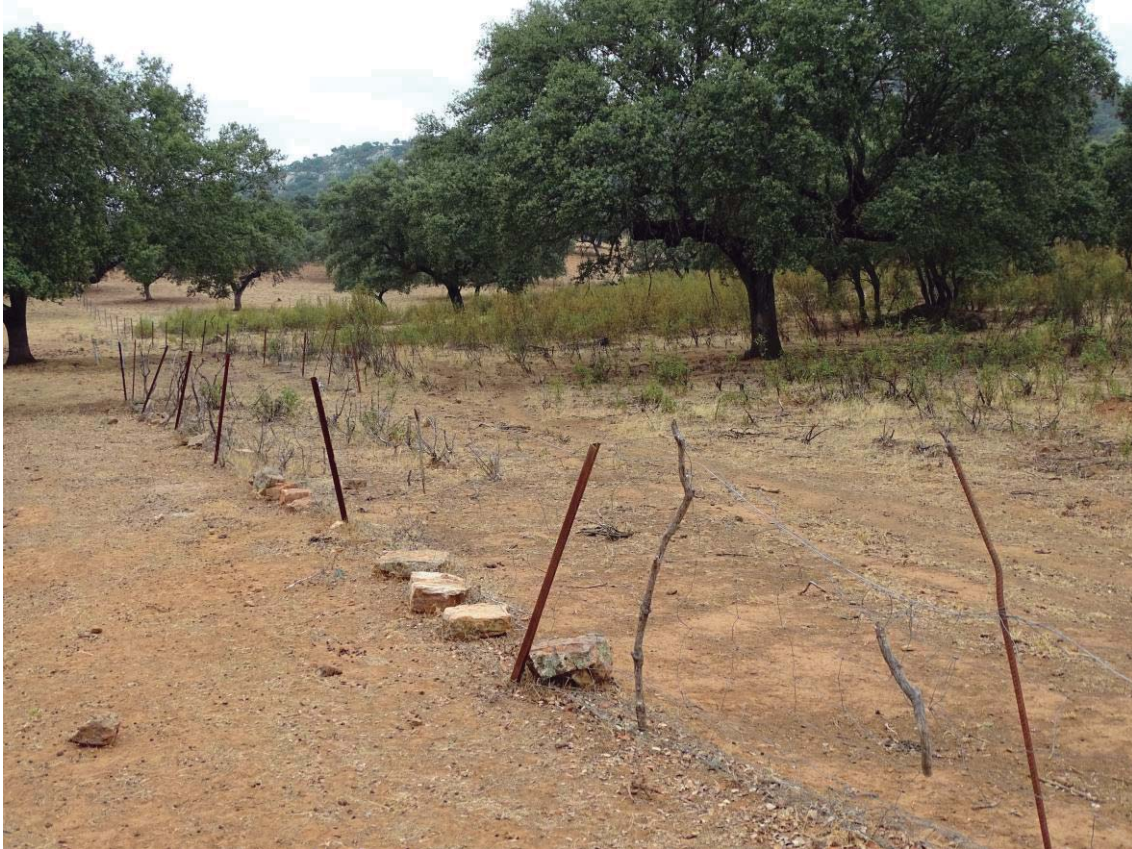
Figura 2: Vallado de tipo ganadero en mal estado de conservación y poco funcional.
